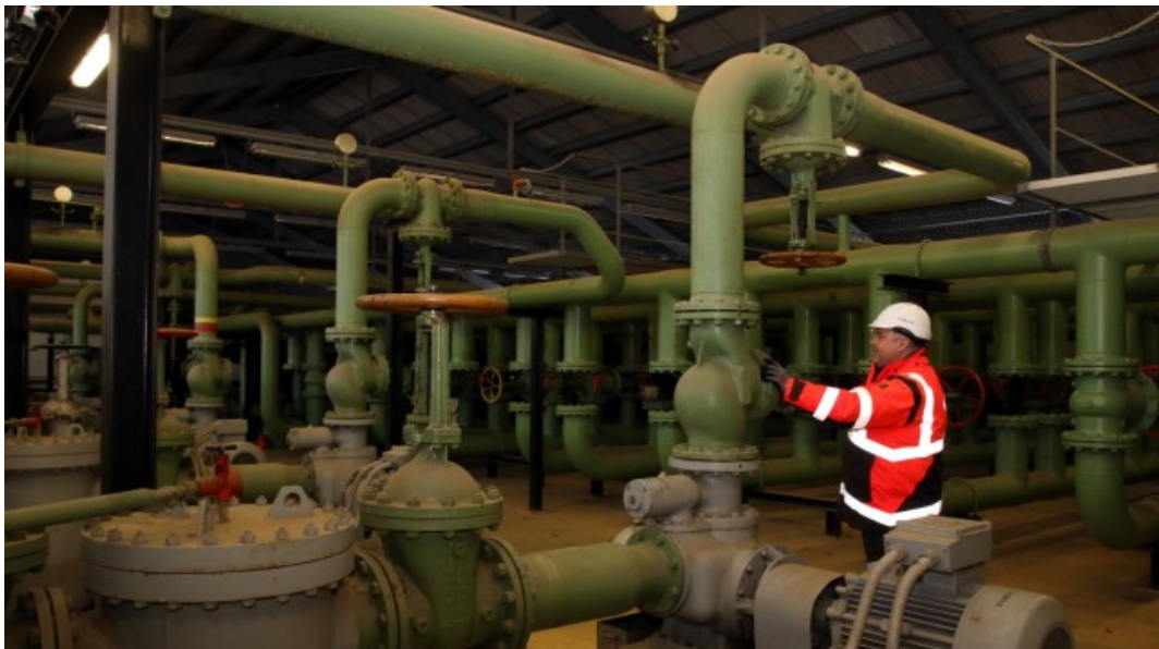
Mit dem Geflecht an Rohren in der Pumpstation des Kraillinger Tanklagers kennt sich Markus Neubauer aus. (Foto: Franz Xaver Fuchs)
